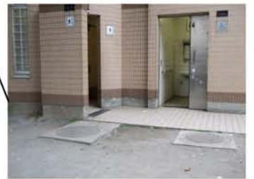
■せっかくの障害者用トイレも入口が段差に。
