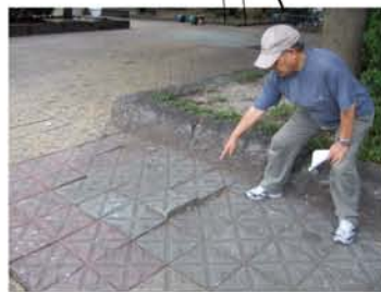
■敷石がはがれ、浮き上がったしまった床面。
