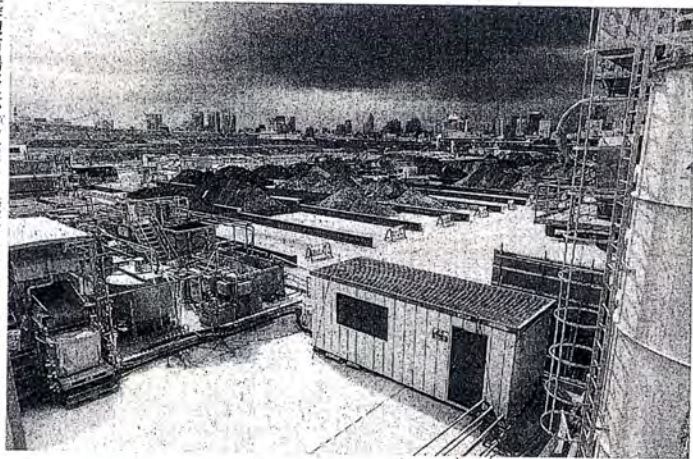
築地市場移転予定地の土壌汚染対策工事現場。江東区豊洲、2012年8月4日撮影
